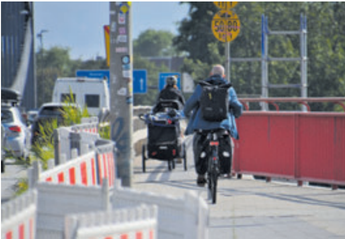
Die geplante Behelfsbrücke über die Norderelbe habe zu wenig Platz für Radfahrer, findet der ADFC und fordert Verbesserungen Foto: ADFC
