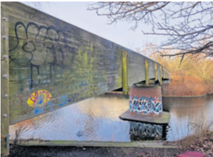
Die Veringkanalbrücke ist marode und muss saniert werden Foto: au
