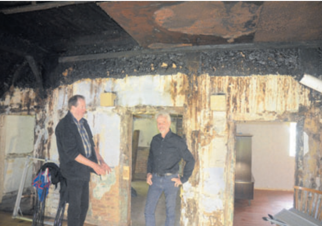
Stephan Kaiser (l.) und Henning Reh stehen vor der alten Tür zur Speisekammer. Die eklig-schleimig aussehende Schicht im oberen Wandbereich sind die Sottschichten, die sich im Lauf der Jahrhunderte gebildet haben Foto: mk
