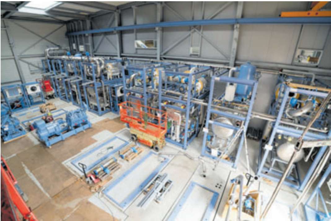
Erste Komponenten der zwei 4-stufigen Wärmepumpen sind installiert
