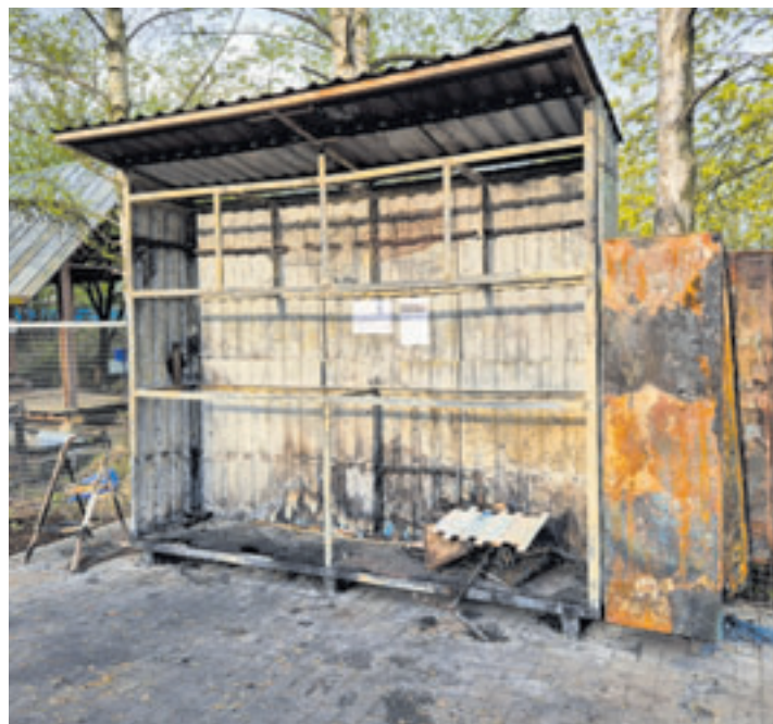
Die Soli-Box einige Tage nach dem Brand: Das Grundgerüst hat dem Feuer getrotzt, vieles muss allerdings repariert werden Foto: au
