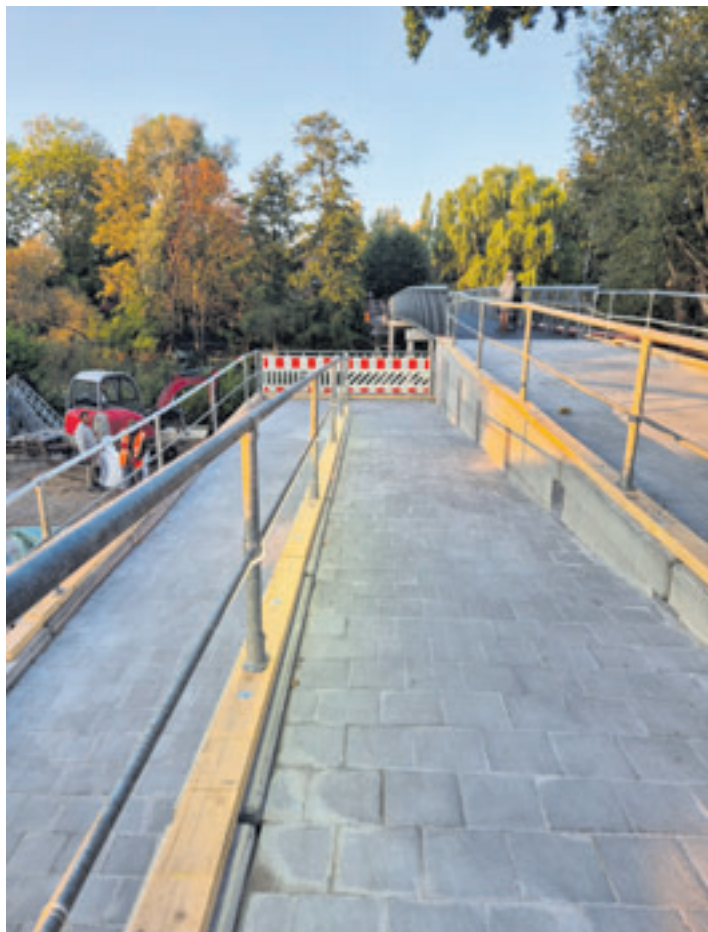
Zwar ist die Schulzenbrücke, eine der wichtigsten Verbindungen für Radfahrer und Fußgänger zwischen Wilhelmsburg und Georgswerder seit dem Neubau jetzt barrierefrei, die Rampe ist aber für Lastenräder und Fahrräder mit Anhänger schlecht nutzbar
