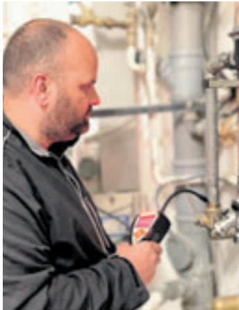
Sicher und störungsfrei heizen mit Gas: Jetzt kommen wieder Prüfer der Hamburger Energienetze ins Haus und checken die im Gebäude liegenden Teile des Gasanschlusses
