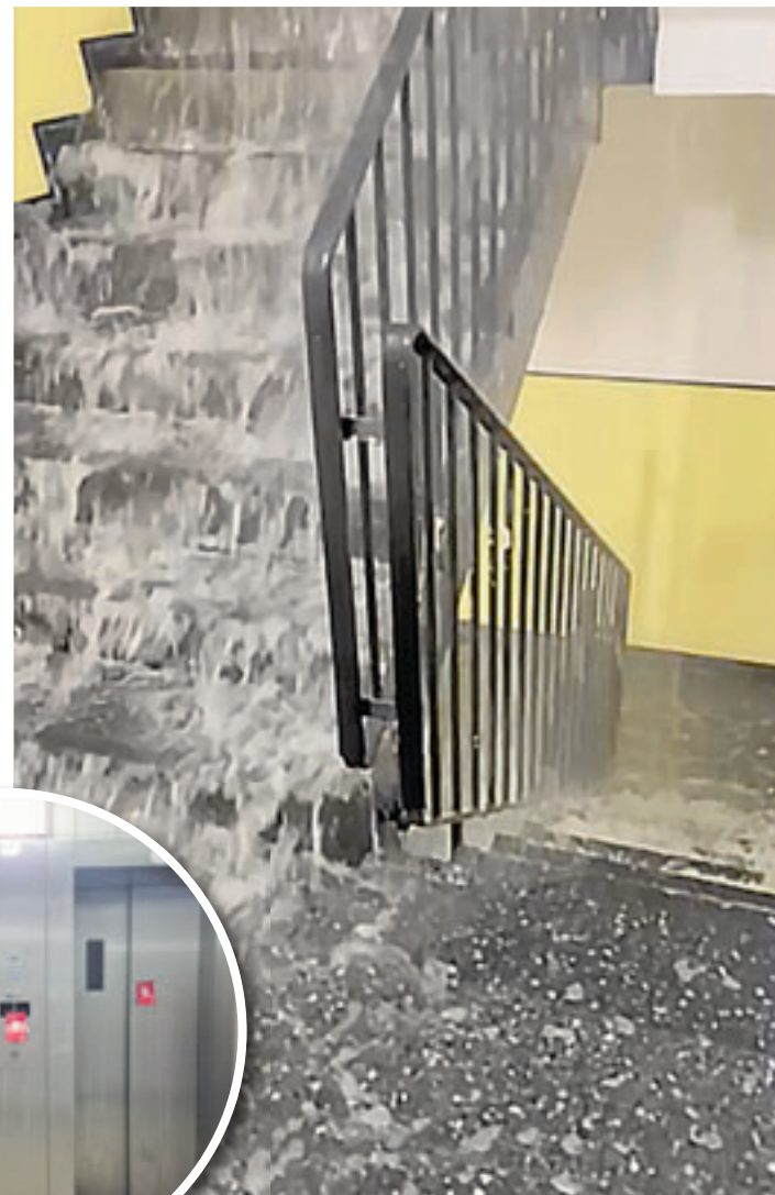
In wahren Sturzbächen suchte sich das Wasser seinen Weg durch das Treppenhaus im Erlerring 10 Foto: ein
