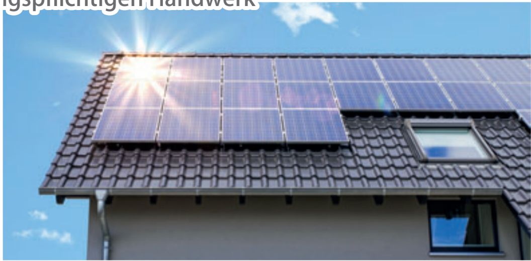
Photovoltaikanlagen auf dem Dach: Nur vom zulassungspflichtigen Handwerk
