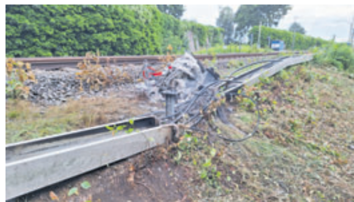
Durch einen Brand wurde der Verteilerkasten zerstört
