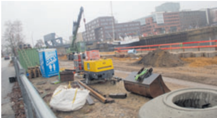
Bei den Sanierungsarbeiten der alten Kaimauer am Treidelweg wurde gefuscht Foto: mk
