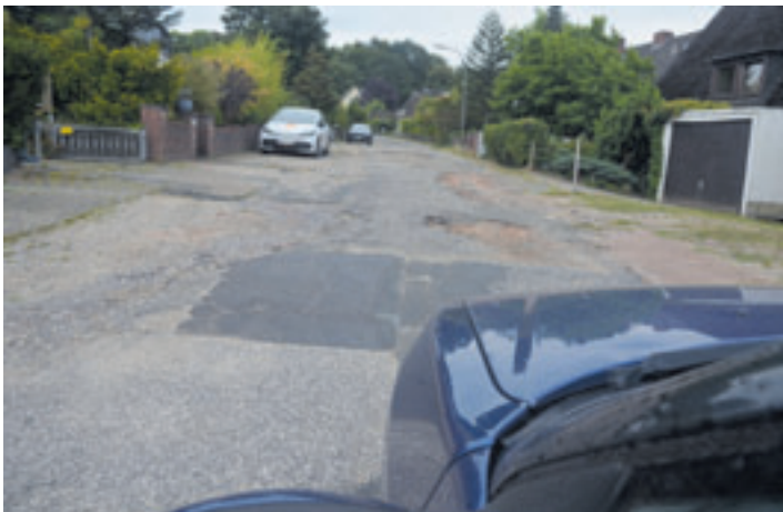
Im Mittelteil des Sunderweges ist der Straßenzustand schlecht
