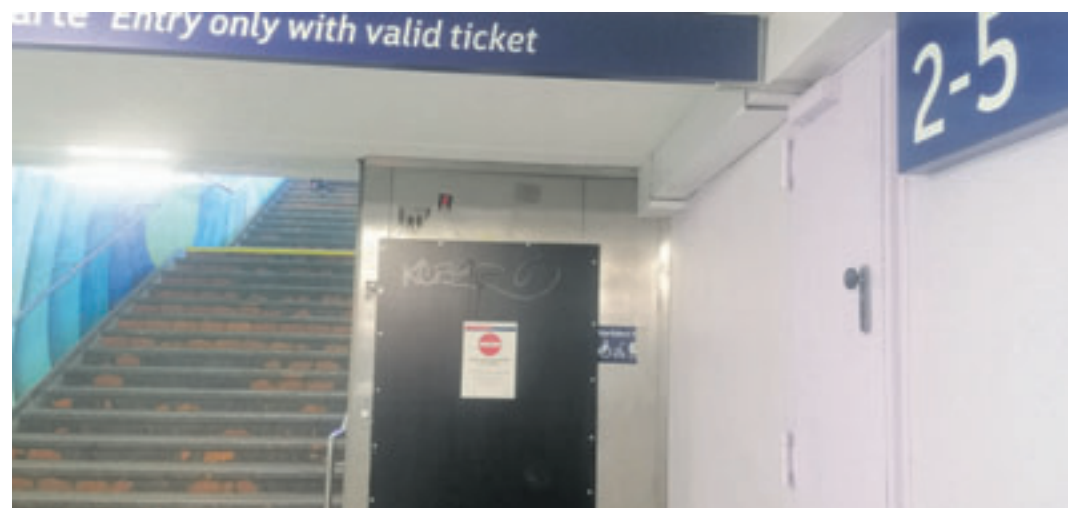
Die Fahrstühle des S-Bahnhofs Neugraben sind seit Wochen defekt
