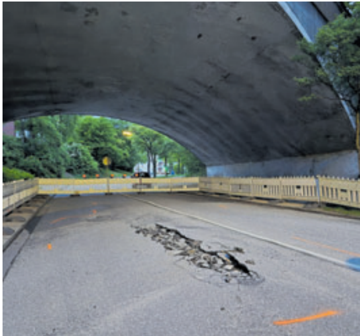
Direkt unter der Unterführung der B75 ist der Asphalt des Marmstorfer Wegs durch eine geplatze Abwasserleitung hochgedrückt worden Foto: au
