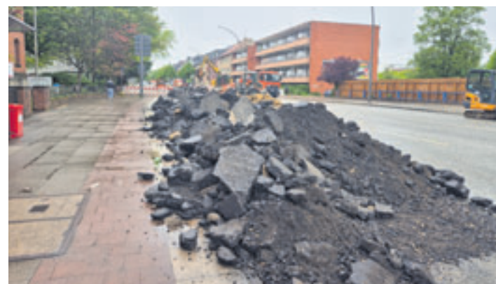
Einen Tag nach dem Wasserrohrbruch: Aufgerissener Asphalt, Sand und Packlage säumen das Bild
