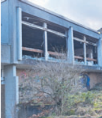
Das Anwesen wird nun unter anderem durch Absperrgitter gegen unbefugten Zutritt geschützt Fotos: HHF
