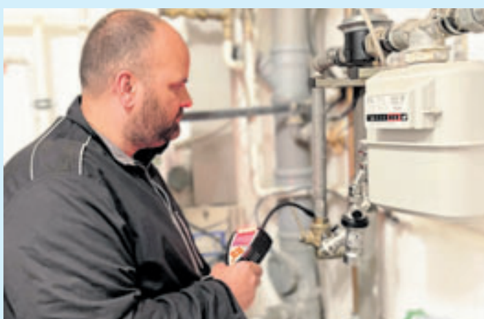
Sicher und störungsfrei heizen mit Gas: Jetzt kommen wieder Prüfer der Hamburger Energienetze ins Haus und checken die im Gebäude liegenden Teile des Gasanschlusses Foto: Hamburger Energienetze
