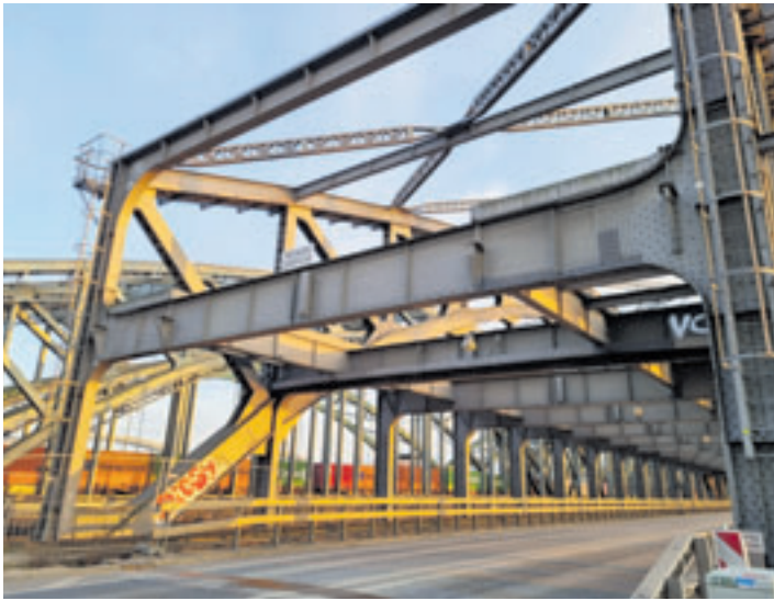
Die Freihafenelbbrücke ist nach der Schiffshavarie im Oktober letzten Jahres nicht mehr zu reparieren. Ein Teil der Brücke soll noch dieses Jahr abgerissen werden Foto: au
