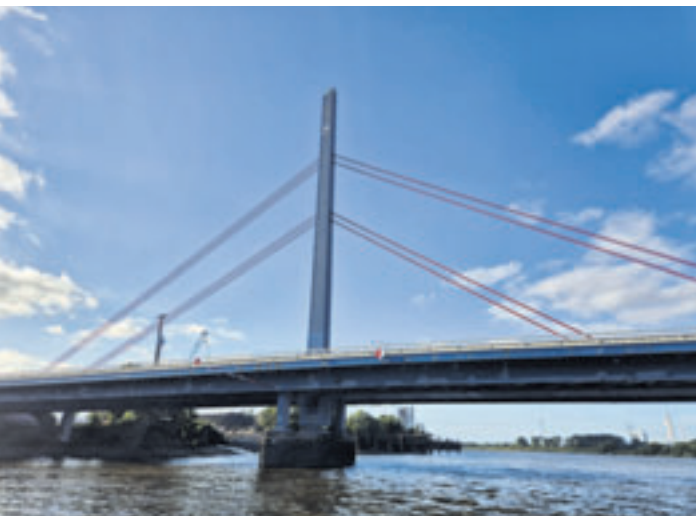
Wegen notwendigen Arbeiten an der maroden Norderelbbrücke wird die A1 für dieses Wochenende in diesem Bereich voll gesperrt
