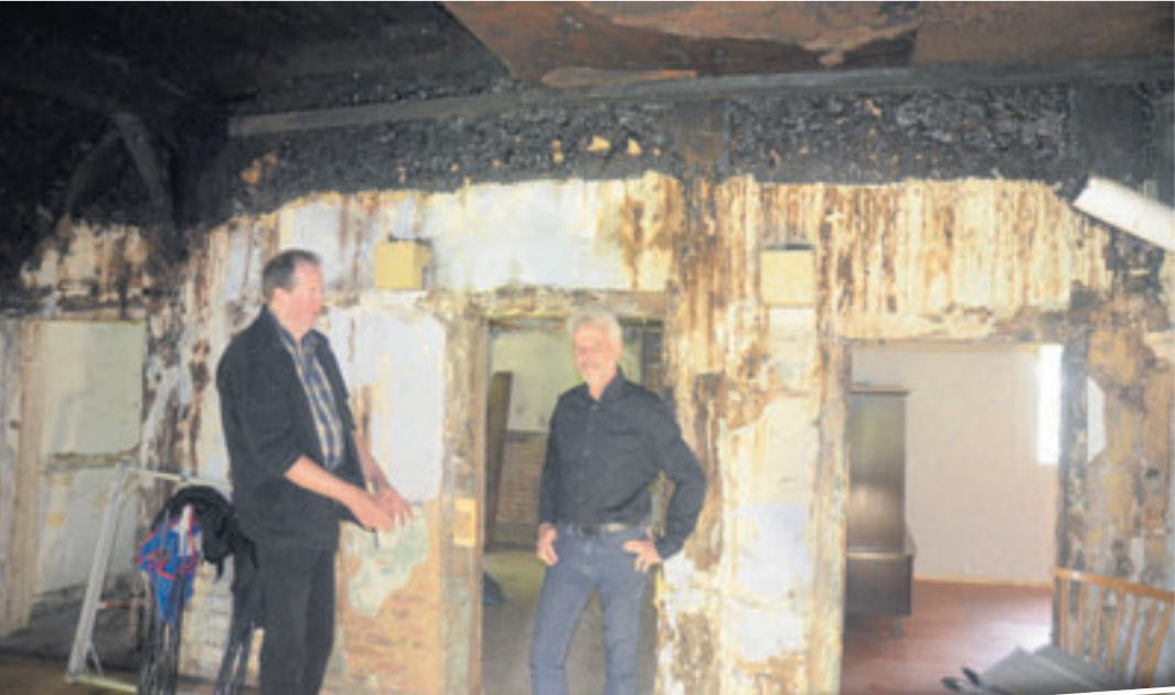
Stephan Kaiser (l.) und Henning Reh stehen vor der alten Tür zur Speisekammer. Die eklig-schleimig aussehende Schicht im oberen Wandbereich sind die Sottschichten, die sich im Lauf der Jahrhunderte gebildet haben
