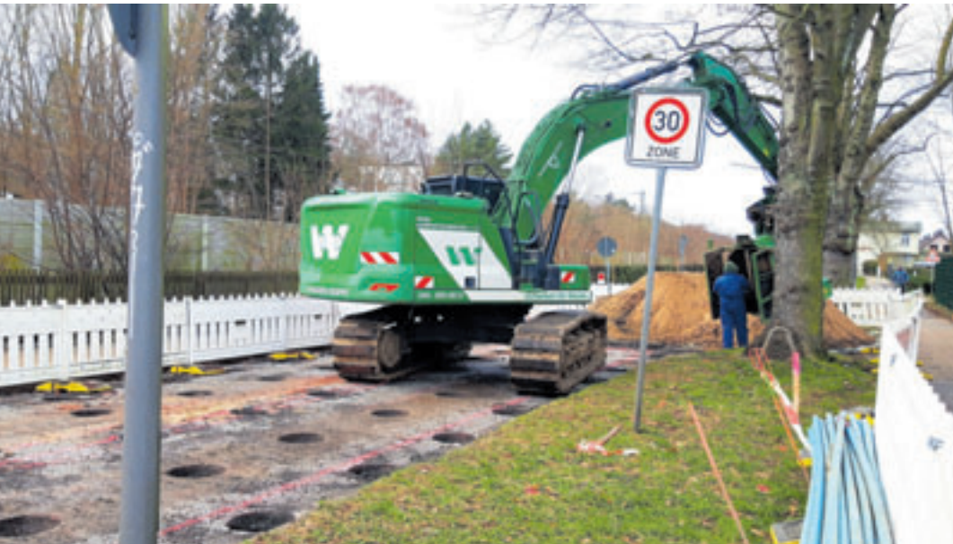
Der weitere Ausbau der Radroute 10 in der Straße Am Radeland zwischen Moorburger Straße und Moorburger Bogen ist aktuell zurückgestellt Foto: W. Marsand
