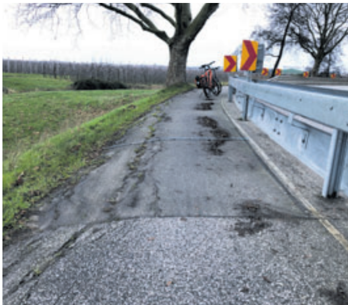
Der einseitige Gehweg, der für den Radverkehr freigegeben ist, befindet sich stellenweise in einem maroden Zustand Foto: Grüne
