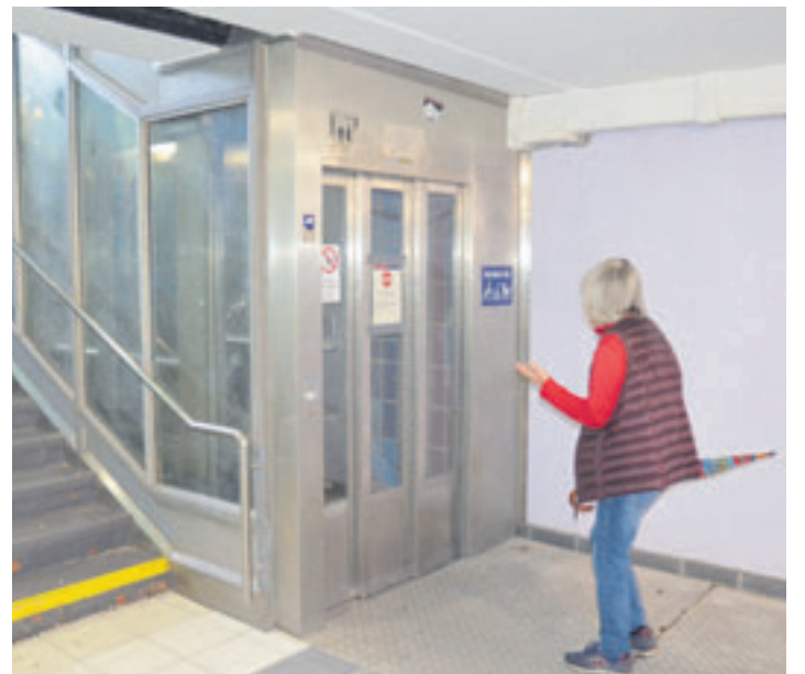
Immer noch defekt: Wann der Aufzug des S-Bahnhofs Neugraben wieder funktioniert, konnte der zuständige LSBG nicht sagen Foto: mk
